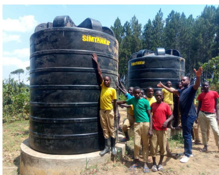
30 m³ Wassertanks, deren Inhalt aus dem Grundwasser hochgepumpt wird
